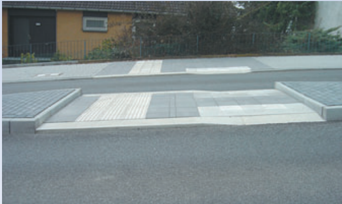
Bild 4: Mittelinsel in Nähe einer Bushaltestelle, errichtet als getrennte Querungsstelle aus dem Bordsteinsortiment der Firma Profilbeton GmbH Borken (Fulda, Februar 2008)
