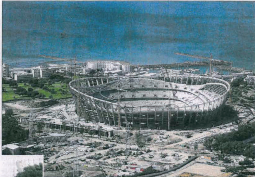
Imposant: Der Umbau des Stadions Athlone am Kap der Guten Hoffnung. Überall wird in Kapstadt für die Fußball-WM im kommenden Jahr gebaut. Fotos: privat
