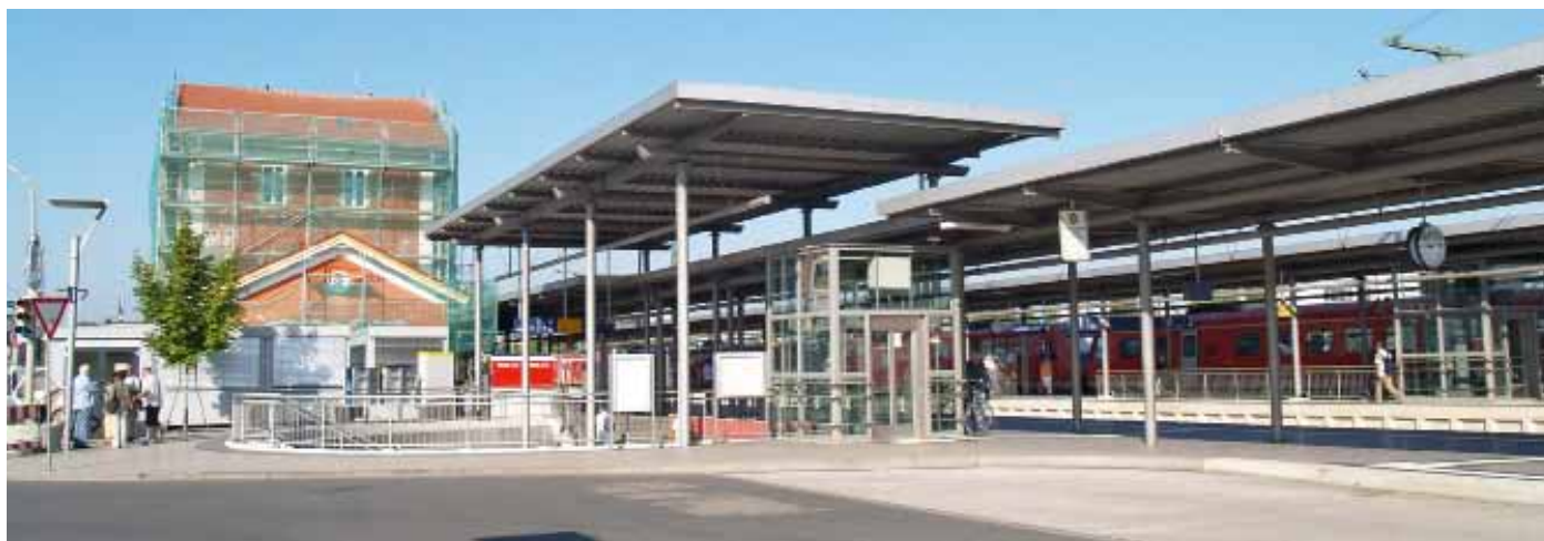
Unter dem erhöhten Dachelement befindet sich der Eingang zur Fußgängerunterführung, die zu den Gleisen 1 und 2 führt. Das historische Empfangsgebäude (links) wird zurzeit saniert und soll voraussichtlich im Oktober 2011 fertig sein. Rechts der Kombibahnsteig.
