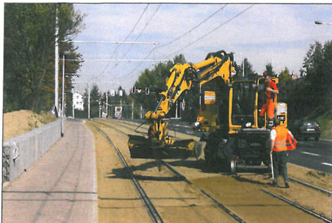
„Kasseler Rasengleis“ im Entstehen in Vellmars Musikerviertel; wir sehen die Arbeiten zum Einbringen der Rasentragschicht kurz vor dem Abschluss. Innerhalb weniger Tage hatte sich der Schotterbahnkörper in ein Rasengleis verwandelt und die Anmutung einer gepflegten Grünanlage angenommen.
